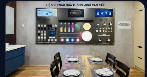
Bảng demo hệ sinh thái nhà thông minh cao cấp
